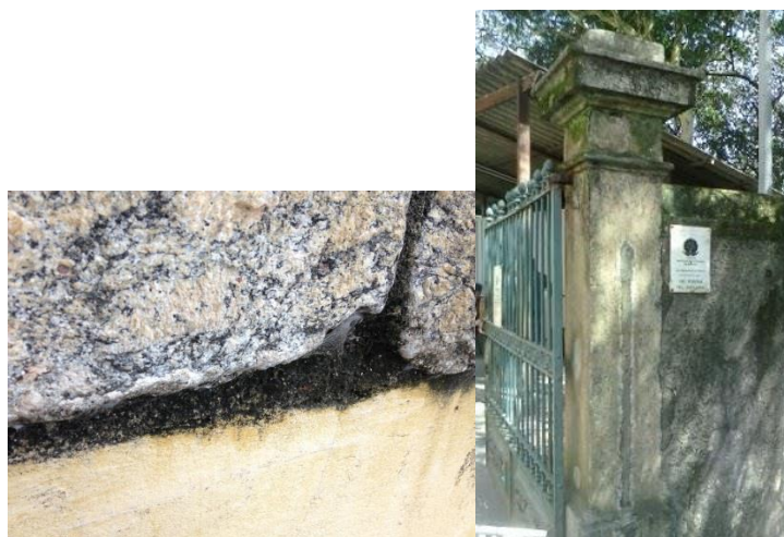
Figura 4.1.3: Colonização biológica na fachada e pilastras. 11
