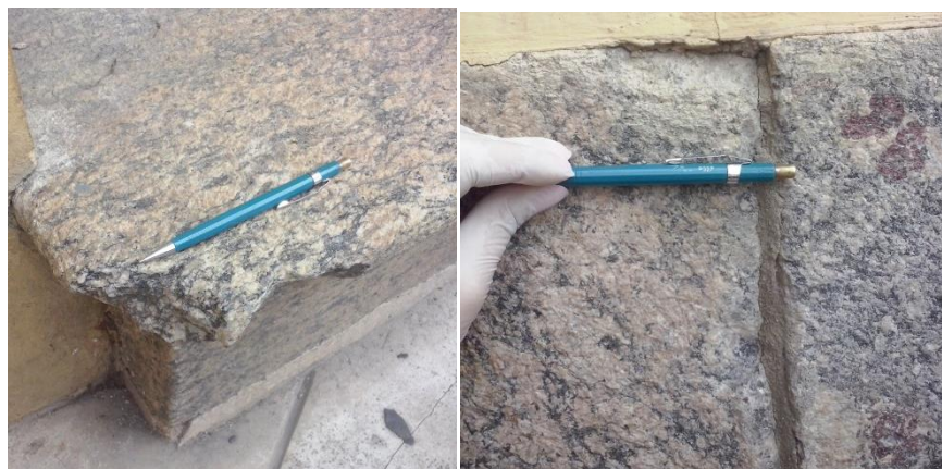
Figura 4.1.2: Fraturas e fissuras encontradas nas rochas
